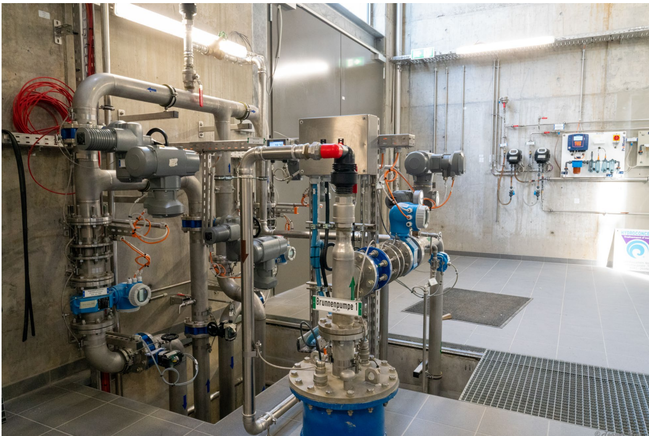
Vue sur les tuyauteries © Ville de Luxembourg
