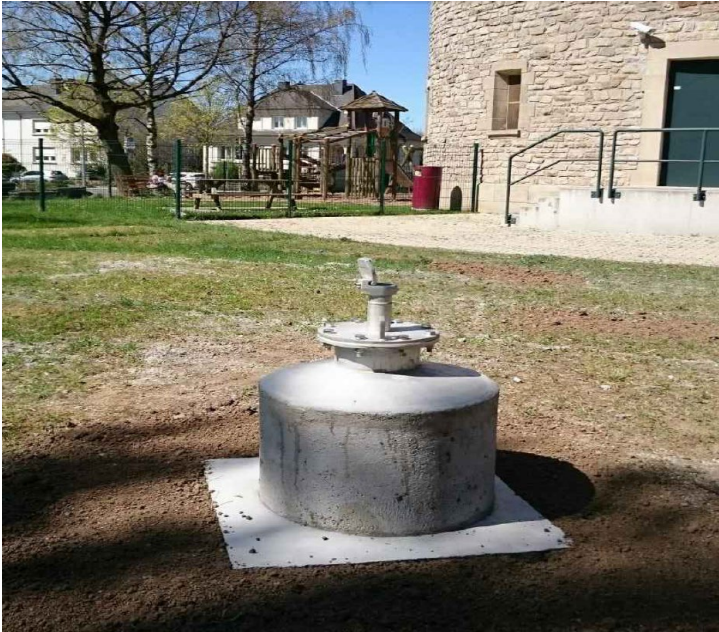
Tête de puits du forage de reconnaissance © Ville de Luxembourg
