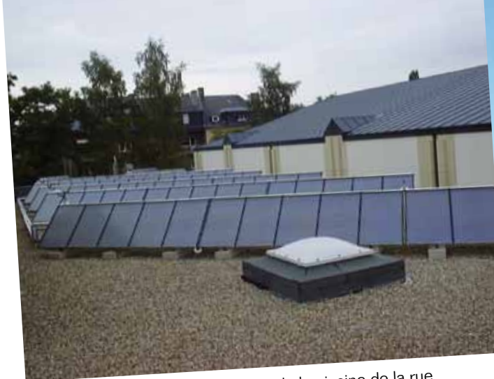
Collecteurs thermiques sur le toit de la piscine de la rue Batty Weber / Wärmekollektoren auf dem Dach des Schwimmbads in der Rue Batty Weber
